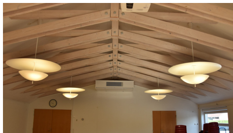
Enheden placeret under loftet
