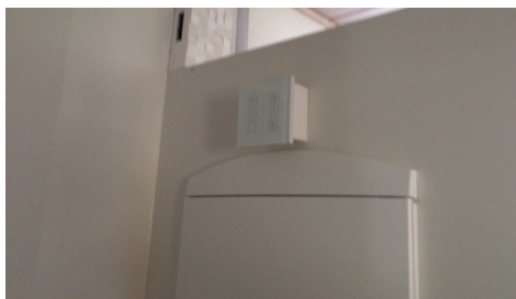
Styringen monteret i rækkehuset
