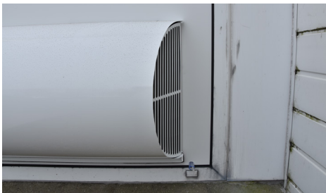
Udvendig stormskærm og afløb fra drænpumpen
