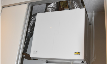
Aggregatet er monteret i bryggerset
